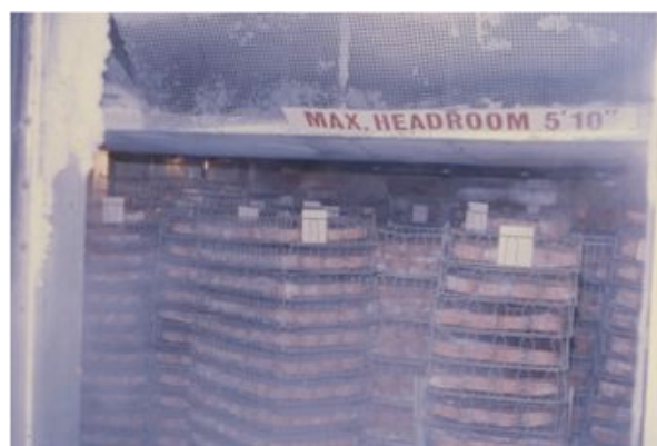
Simple blast freezer
